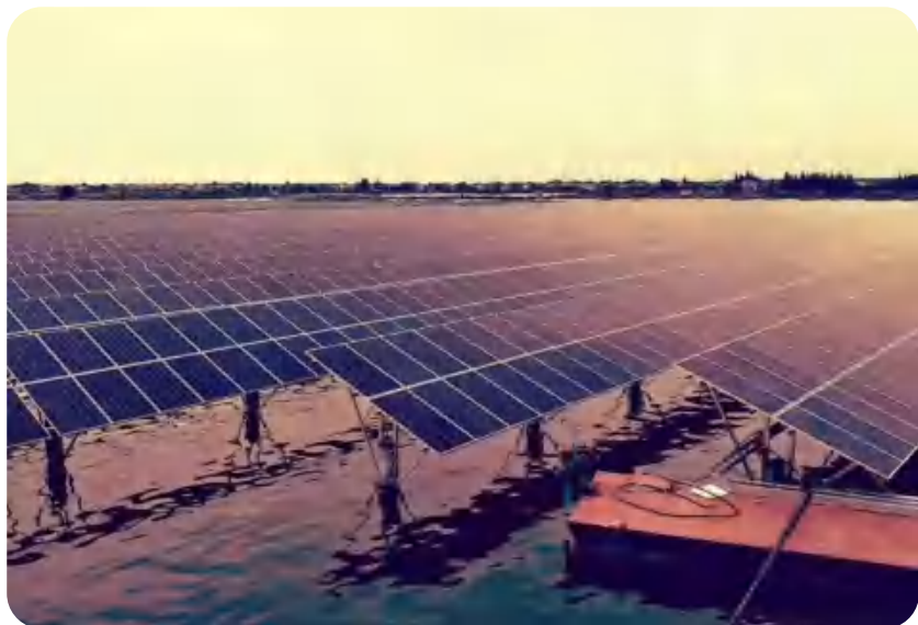
岭北镇鼻湖光伏发电（岭北镇摄）
