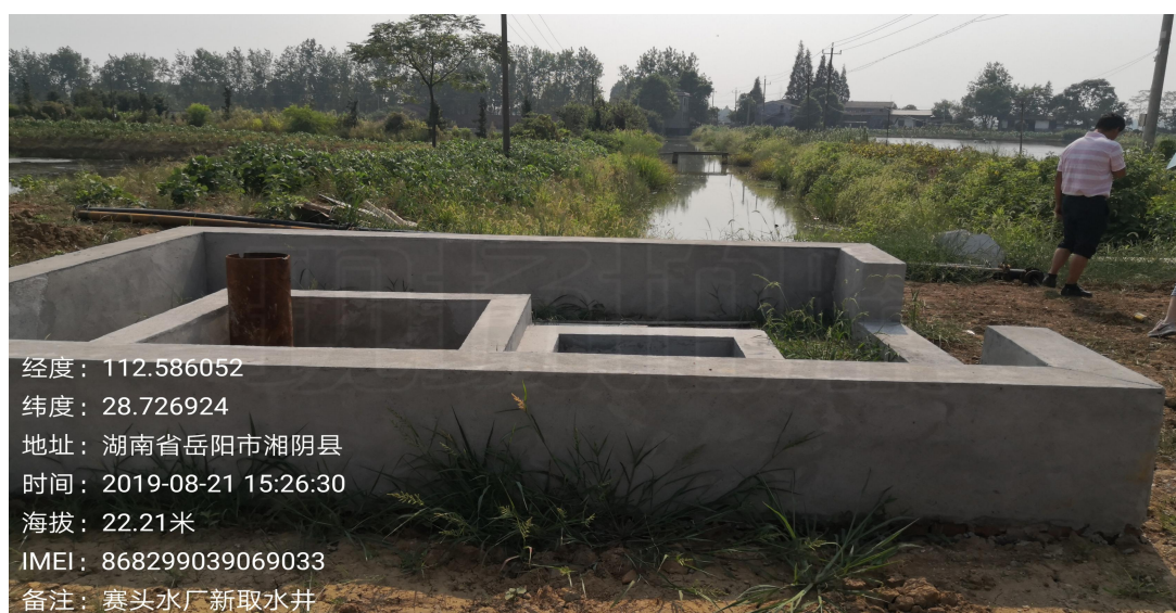
赛头水厂新水井照片
